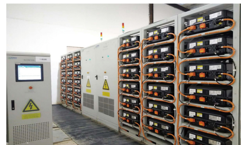
锂电池及 BMS 系统
