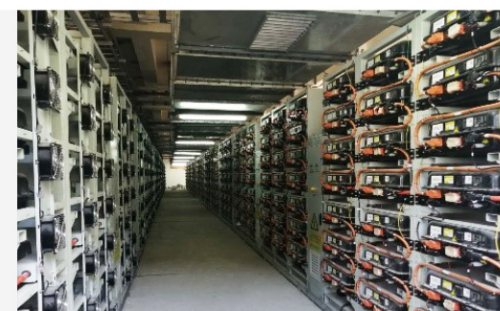
锂电池及 BMS 系统
